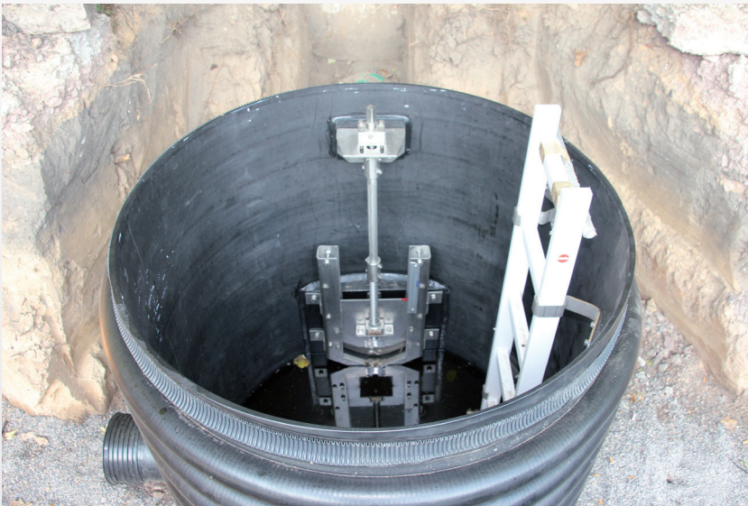
Drosselschacht DN 1200 mit mechanische VA-Drosselschieber für Regenrückhaltung Flow control chamber DN 1200 with mechanical throttle valve for rainwater retention
